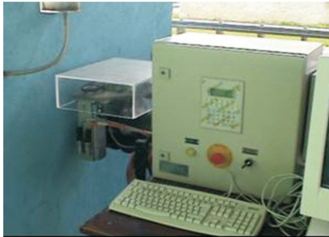
Figura 3. Servomotor y PLC de la instalación
